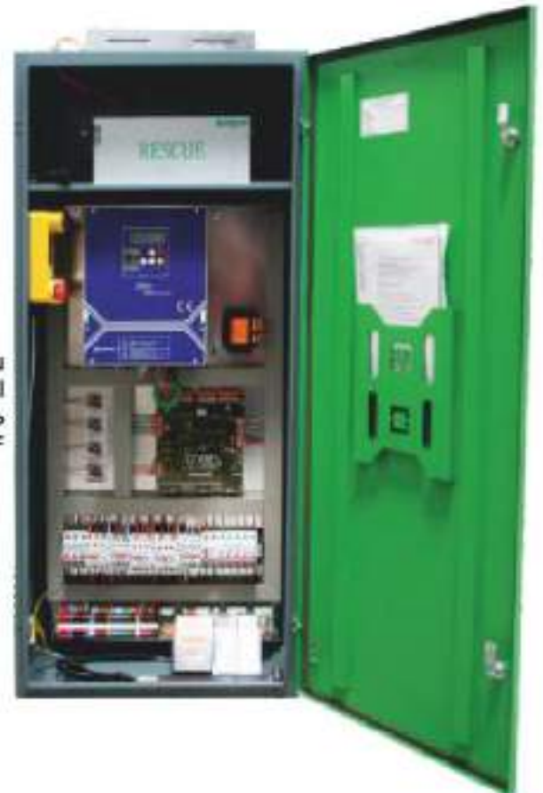
VVVF Kumanda Panosu VVVF Control Panel Панель управления VVVF
